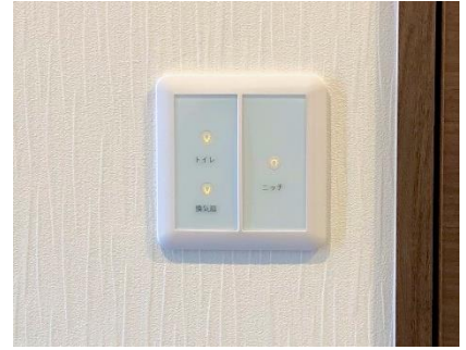
廊下：タッチスイッチ
